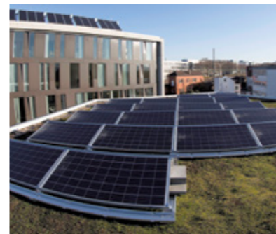
PHOTOVOLTAIKANLAGE JUGENDHAUS BAD CANNSTATT
