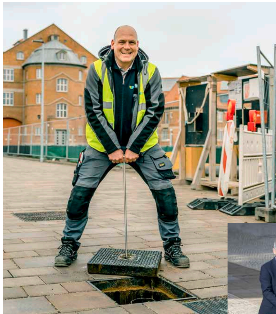
Wärme stinkt nicht: In unseren Abwasserkanälen steckt das größte Potenzial für die Gewinnung erneuerbarer Wärme in Stuttgart. Wie hier im Neckarpark wollen die Stadtwerke künftig an vielen Orten in Stuttgart Wärme aus Abwasser nutzen.
