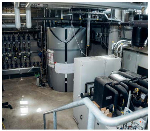
Die Wärmezentrale im Keller des EnergieCampus ist ein zentraler Bestandteil des Nachhaltigkeitskonzepts des Gebäudes und trägt zur Energieeffizienz bei.
