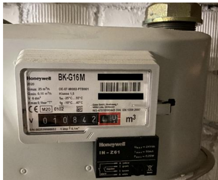
Abbildung 5: Gaszähler mit Reedkontakt als Impulsgeber
