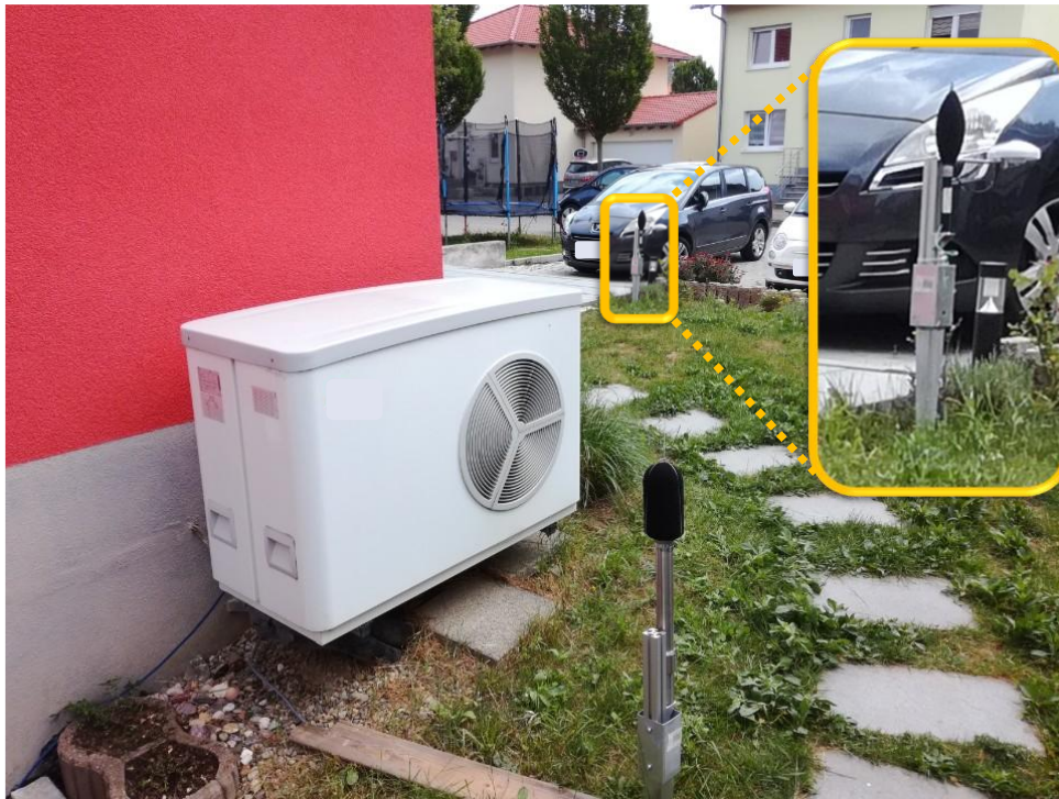
Abbildung 133: Versuchsmessung an einer Außenluft/Wasser-Wärmepumpe (kein Messobjekt in WP-QS im Bestand); im Vordergrund zu sehen ist das wärmepumpennahe Mikrofon, im Detail das zweite Mikrofon zur Erfassung der Umgebungsgeräusche
